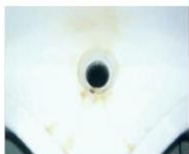
目皿除去 においの発生箇所
