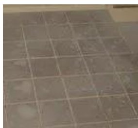
(浴室床の黒ずみ)
